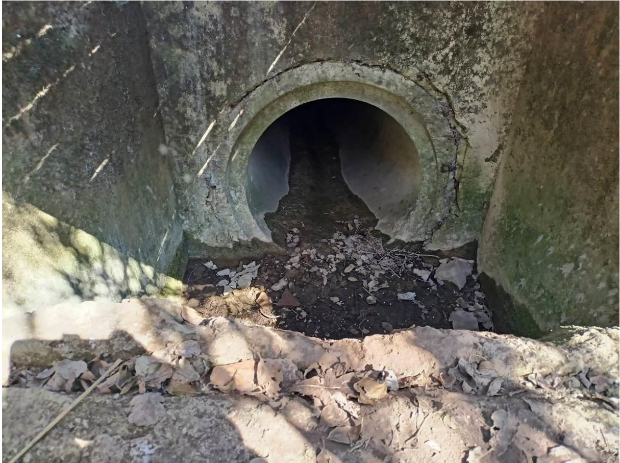
Foto 03 – Dettaglio della tubazione che costituisce l’inizio del tratto tombato del fosso Montefari
