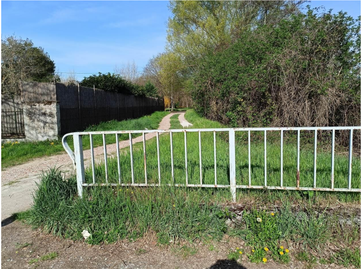
Foto 11 – Inizio tratto argine Sieve oggetto di sovrizzo per la messa in sicurezza al Tr 30 anni
