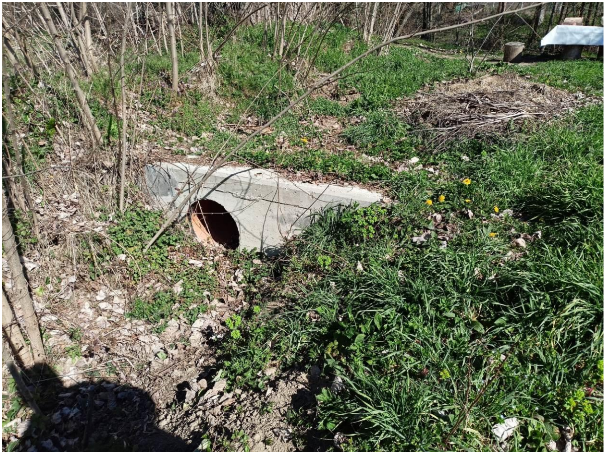
Foto 21 - Vista lato campagna tubazione di scarico fosso minore di monte
