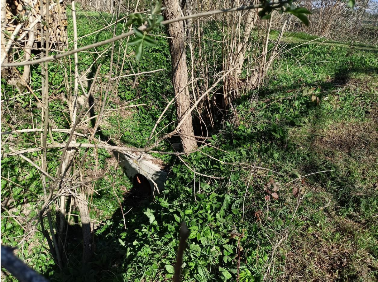
Foto 23 - Vista lato campagna tubazione di scarico fosso minore di monte
